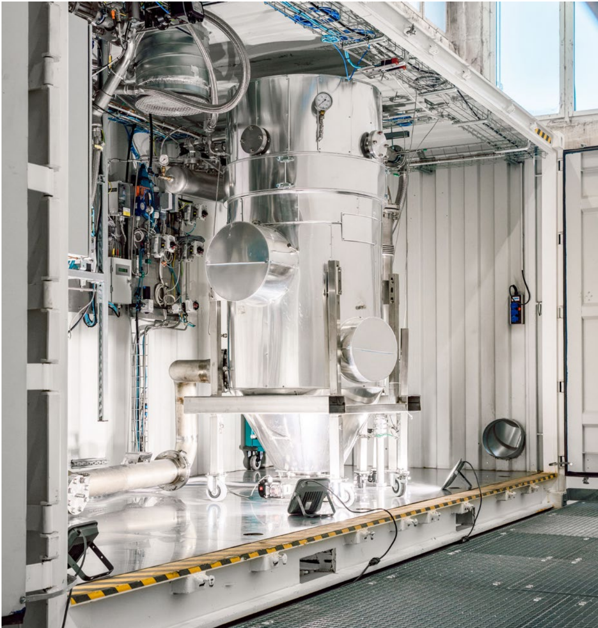
Methan-Pyrolyse-Anlage im Tech Cluster Zug
