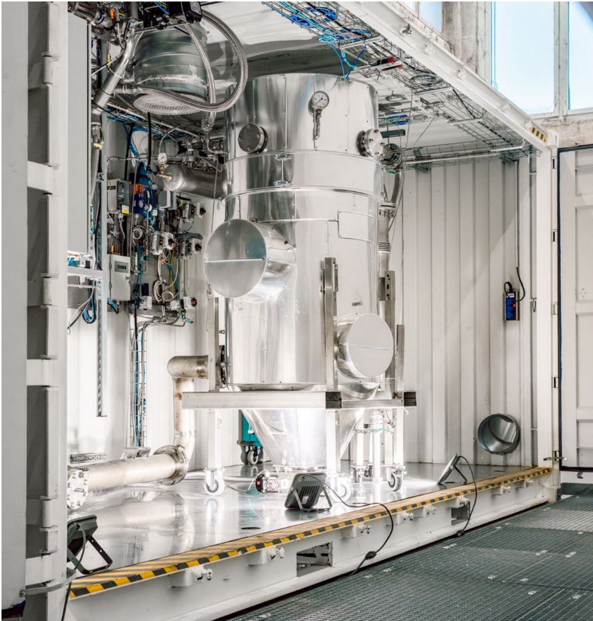
Methan-Pyrolyse-Anlage im Tech Cluster Zug
