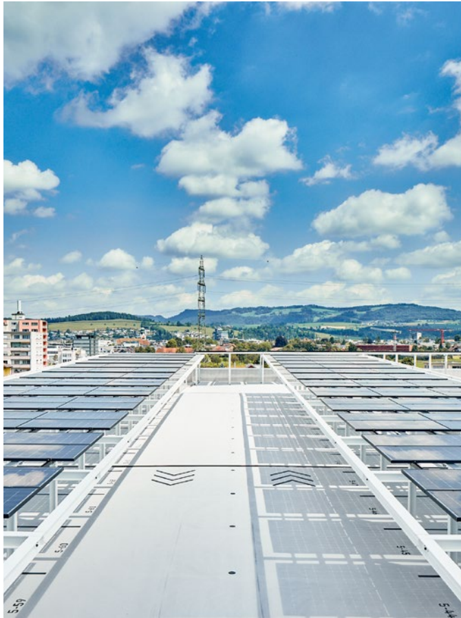
Solaranlage mit 72.5 kWp installierter Leistung auf dem Mobility Hub Zug Nord
